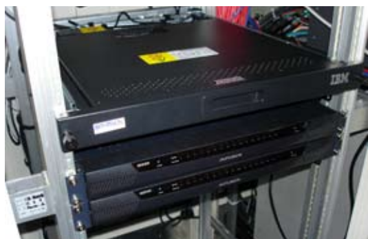
ラックにマウントされたKN2116(2台)
