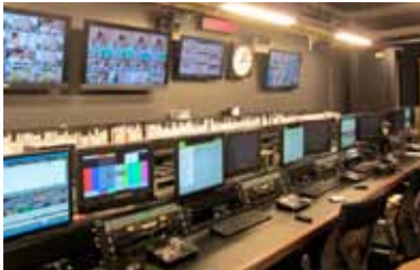
各卓には KM0932 のコンソール モジュール KA7230 を設置。放送状況の監視にも VE200 を取り入れ、効率的に作業できる環境に。
