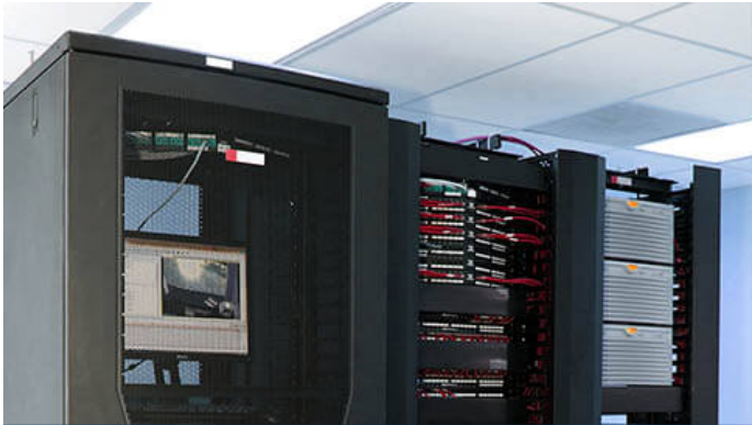
Sala de servidores
