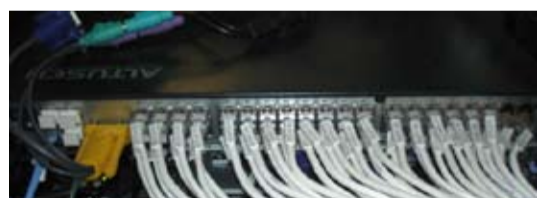
LANケーブルですっきりと配線された KN2140vのリアパネル
