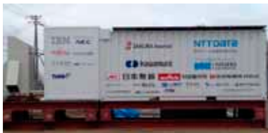
HVDC 屋外実証実験コンテナ
