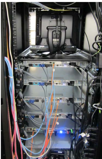
コンピューターモジュール (ラック左側の支柱にマウント) と Cat5e ケーブルによる配線でラック背面もすっきり
