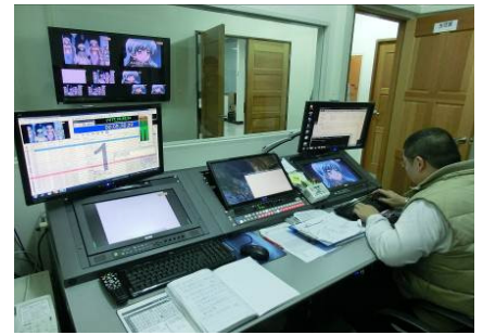
使用 KM0932 可供主控室 24 小時監看影片播放狀態，並於發生問題時能立即啟用備援系統
