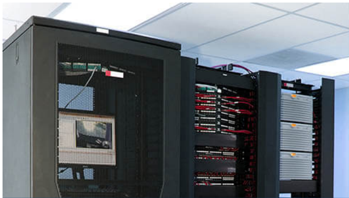
Sala de Servidores
