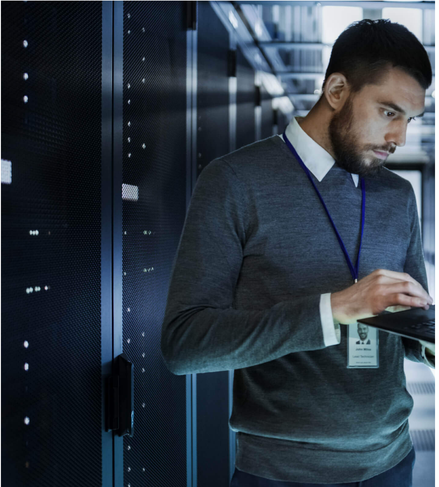
Sala de servidores
