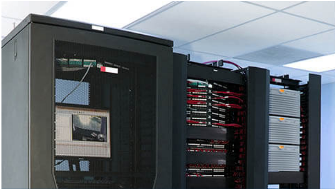
Sala de Servidores
